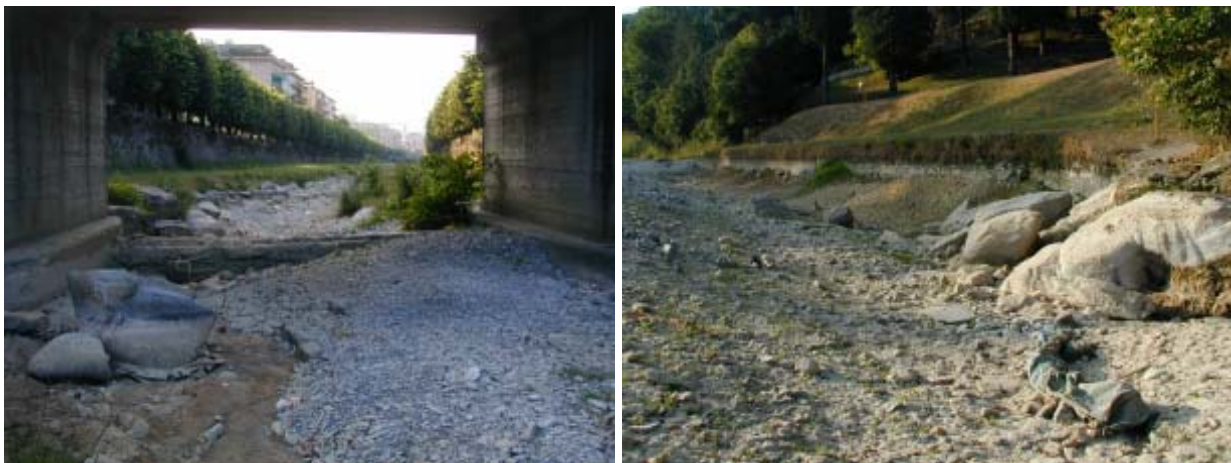
Figura 12 - ponte viale Torino (a sinistra) e scavo all'esterno della curva (a destra)
