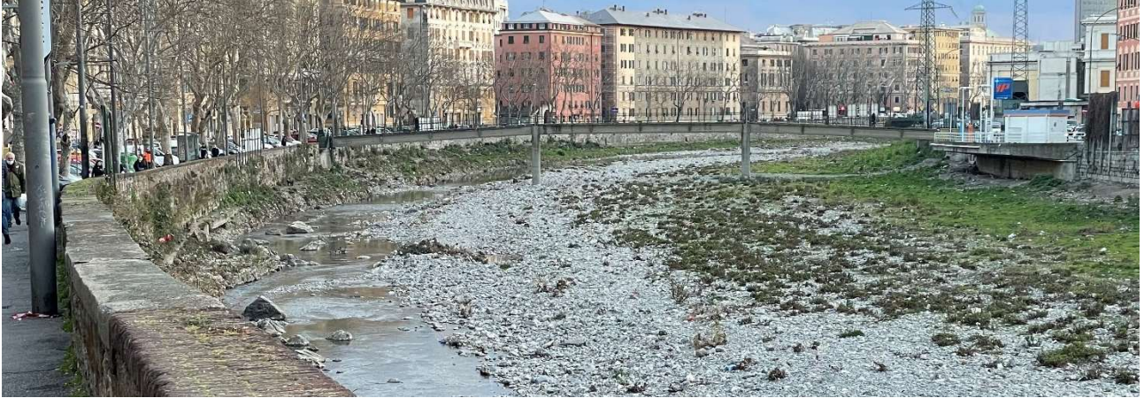
Figura 24 – Passerella Firpo vista da monte. Si osserva il muretto continuo in sponda sinistra, il distributore di carburanti sulla mensola in sponda destra.
