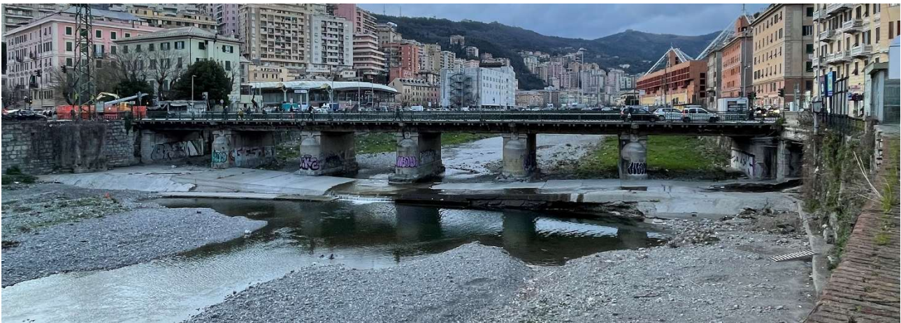
Figura 23 – Ponte Serra visto da valle. In sponda sinistra si ha la confluenza della tombinatura del rio Fereggiano.
