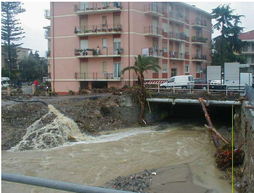
Figura 2.7: Inizio della tombatura a valle della rotonda di via Romana, si può notare l'argine tracimato in sinistra idrografica.
