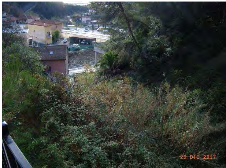
Vista della porzione terminale dell'area in dissesto
