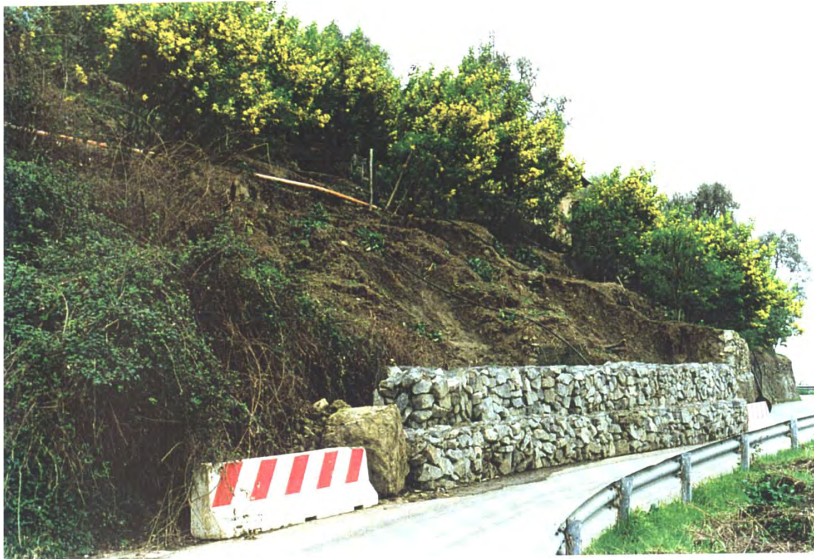
FOTO 6 - Riattivazione superficiale nel grosso corpo franoso in località Frantoio Massabò. La frana di scivolamento è stata oggetto di specifica scheda.
