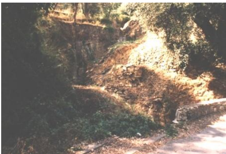
Foto 1: muri d'argine a secco crollati nella parte alta del Rio Gorleri
