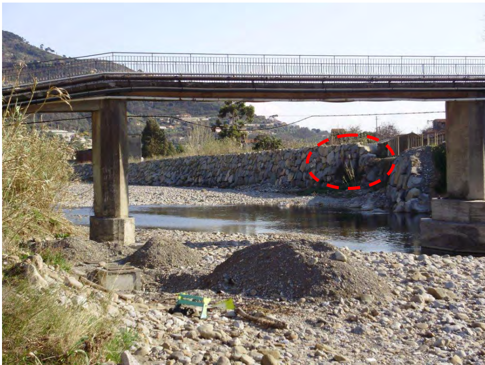
Figura 5.19 - Ponte di Cian de Cà visto da monte con evidenziato un franamento del muro di sponda destra.
