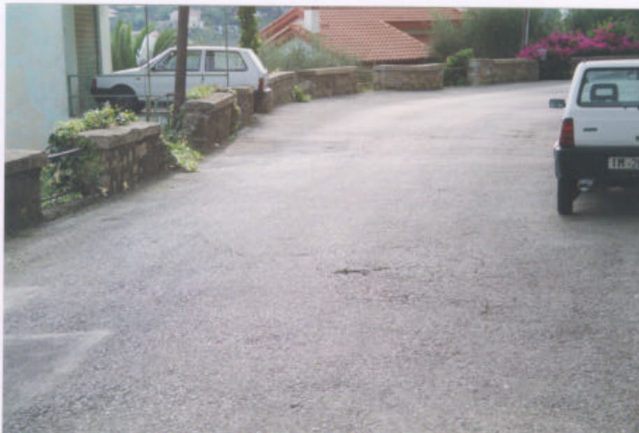
FOTO frana 118/55 Ambito di bacino n° 3 Sanremese Bacino S.Romolo località BorgoTinasso
