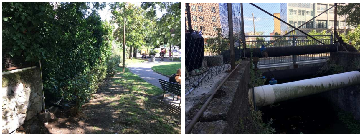
Figura 77 – Tratto a monte di Via Vittorio Veneto dove il muro in sponda destra presenta un ribassamento di 1,2 m (sx). Attraversamento di viale Italia visto da monte (dx).
