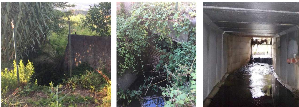
Figura 75 – Imbocco del tratto tombato RO_C1: vista dal piano campagna in sponda destra (sx); da monte (centro); da valle all'interno della tombinatura (dx).
