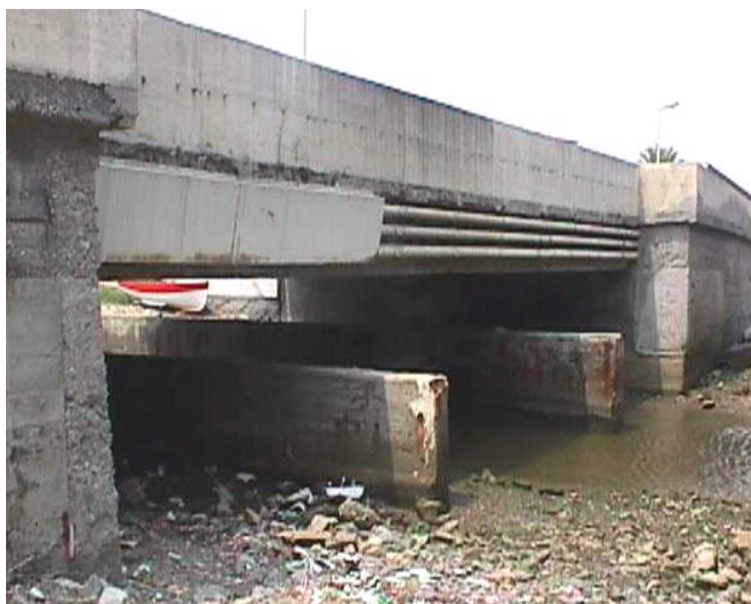
Figura 2.6.3.5 – Rio Antognano: particolare restringimento sotto il ponte della vecchia Aurelia. Il ponte ha un impalcato di circa 1,8 m X 15,8 m. Da notare i muretti in calcestruzzo che contraddistinguono il restringimento e portano la sezione a geometria rettangolare. L'altezza misurata dal fondo alveo all'impalcato è di circa 2 m.
