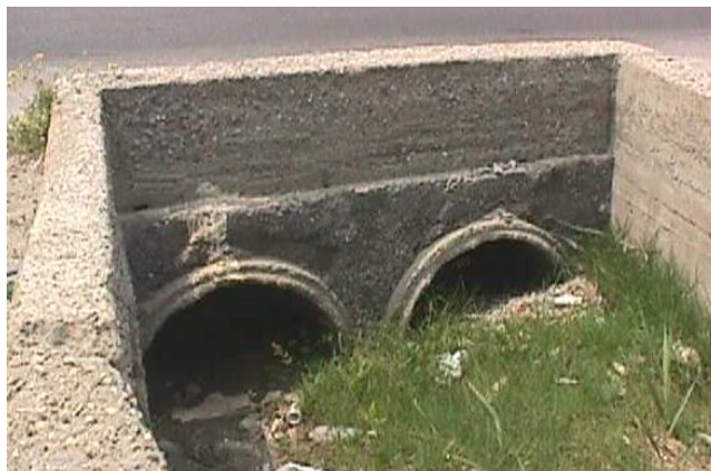
Figura 2.6.3.9: Primo rio dopo Antognano: particolari dei tubi in calcestruzzo che collegano la sezione a monte della vecchia Aurelia, con il tratto terminale. Da notare l'ostruzione in terra di fronte ai tubi, che di fatto copre circa la metà della apertura disponibile.
