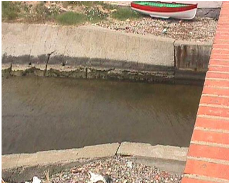
Figura 2.6.3.4 – Rio Antognano: restringimento prima del ponte della vecchia Aurelia.
