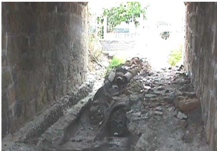
Figura 2.6.3.11 – Secondo rio dopo Antognano: sezione dello sbocco a mare sotto il rilevato ferroviario.
