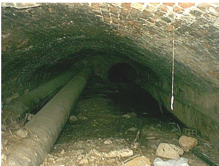
Figura 3.4.1.1.7 – Copertura sotto l'ingresso del cimitero. In lontananza si può scorgere il tubo che raccoglie le acque del compluvio.
