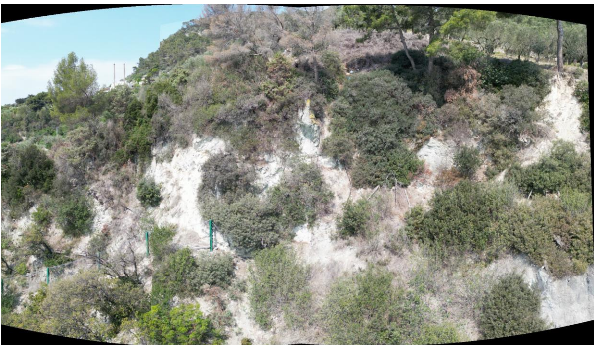
Figura 8 ter: vista da drone del margine della scarpata superiore (zona ovest) con evidenza di fenomeni di erosione avanzata, con innesco di locali scivolamenti delle coltri superficiali, fino a evidenze di arretramento della stessa.
