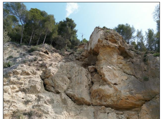
Figura 6/6bis: vista da drone del dissesto 2019 e particolare del fronte con fenomeni cavernosi
