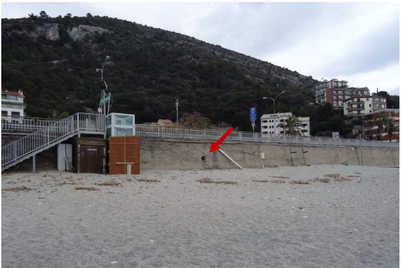
Vista dello sbocco della tombinatura del Rio Maremma presso la spiaggia (vedi freccia).
