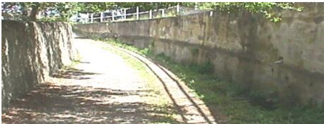
Figura 2.6.2.3.1 – Rio Chiariventi: alveo subito a monte dell'Aurelia. Il muro dell'argine sinistro ha altezza costante di circa 1.6 m, mentre in sponda destra l'argine ha altezza variabile. La strada è larga circa 2.9 m.
