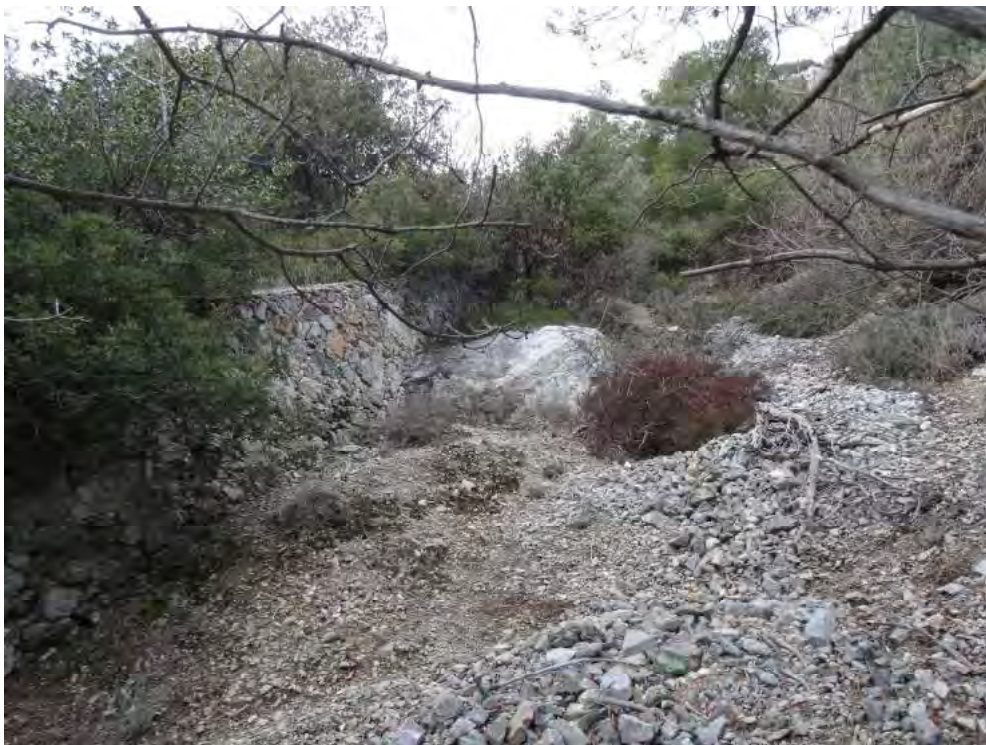
Vista della falda detritica in prossimità del piede del versante, da osservare locali fenomeni di erosione.
