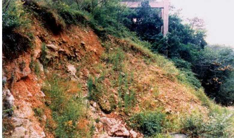
Franosità diffusa in corrispondenza dei viadotti autostradali
